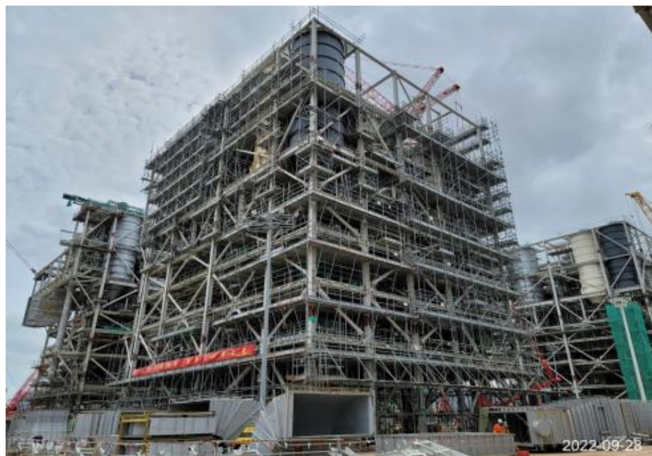
煙氣潔淨機組第4列(2022年10月)
