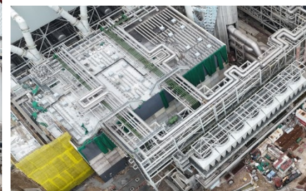
渦輪發電站調試進行中
