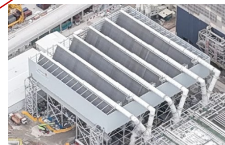
風冷式冷凝器調試進行中
