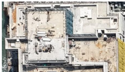
海水化淡設備調試完成
