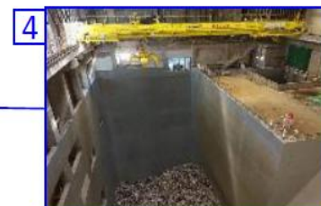
4 固體廢物由廢物儲存坑吊運至焚化爐
